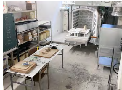
立体室の新設陶芸窯 試運転の様子
