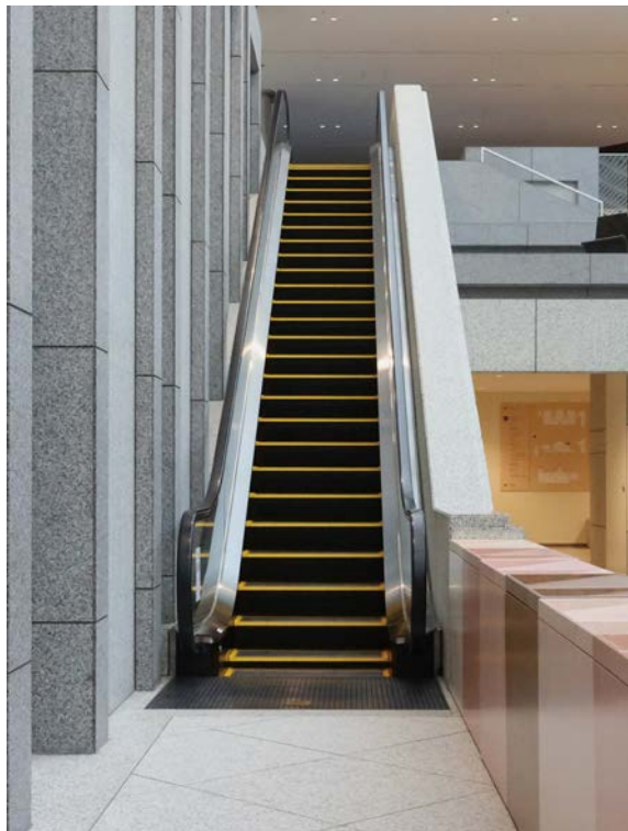
エスカレーター（2階 かい ）
